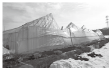
平成26年大雪による被害状況の視察
