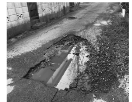
市内の劣化した私道
