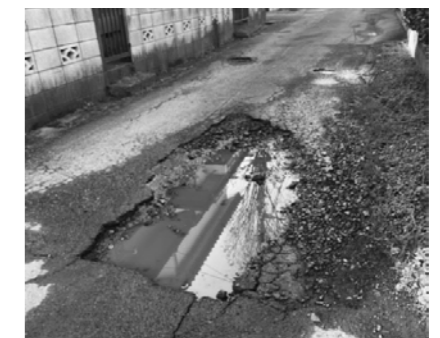
市内の劣化した私道
