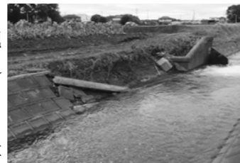
平ブロック護岸崩壊のようす
