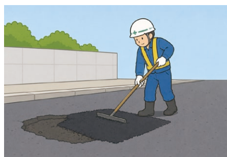
補修は維持管理センターへ連絡を
