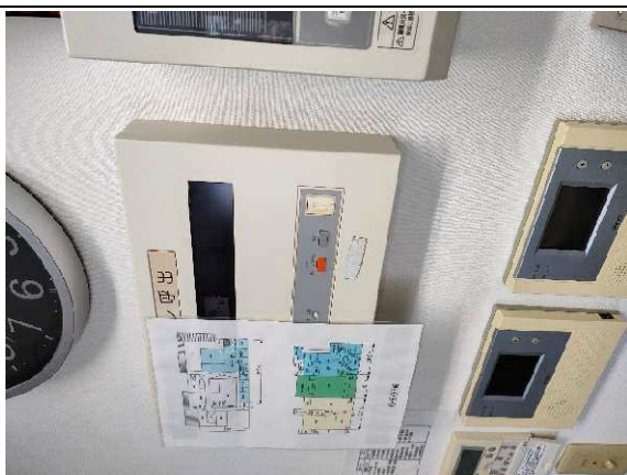
i-75) トイレ呼出装置
