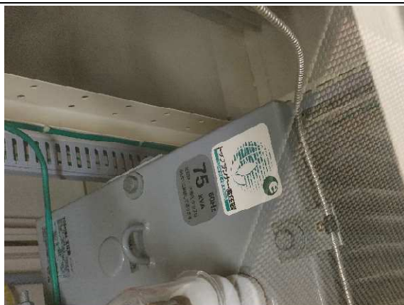
i-87) 変圧器(トップランナー)
