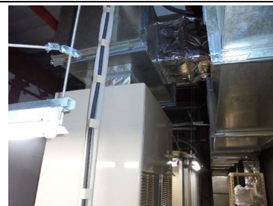
IM-60 天井内空調機器
