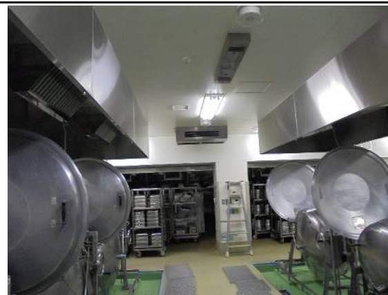
IM-45 排気フード、天吊り型エアコン
