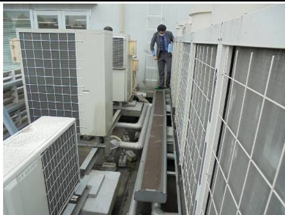
IM-73 マルチエアコン室外機冷媒管
