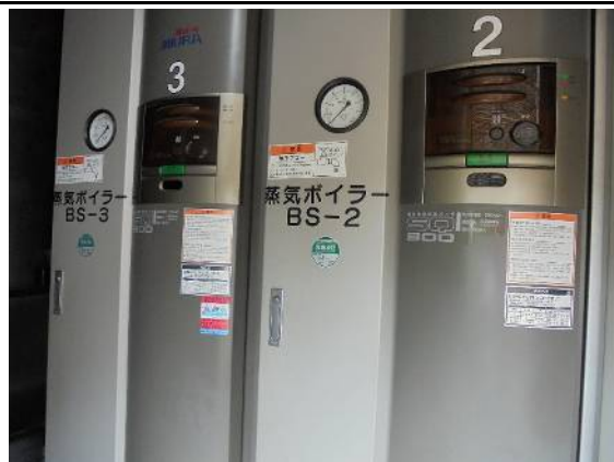
IM-15 蒸気ボイラ
