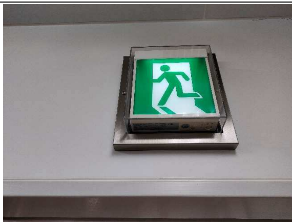
i-38) 避難口誘導灯 (HACCP 対応)
