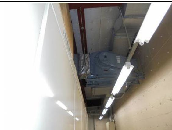
IM-69 電気室排気ファン
