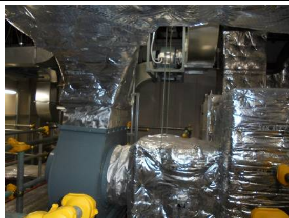
IM-63 天井内給気・排気ファン・ダクト
