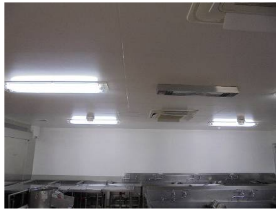
IM-24 天井カセットエアコン、自在水栓
