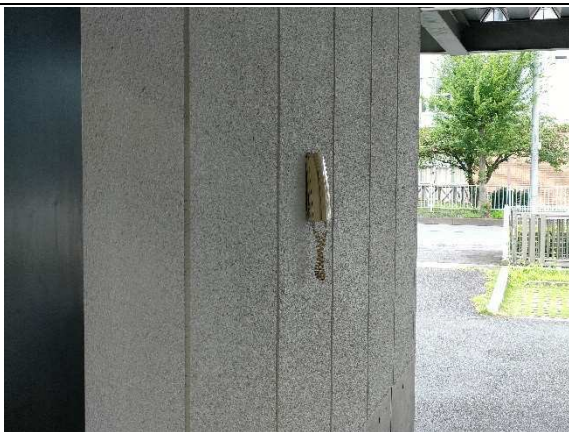
i-41) インターホン子機(取付状況不良)
