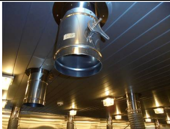
IM-50 排気ダクト(消毒保管庫に接続使用)
