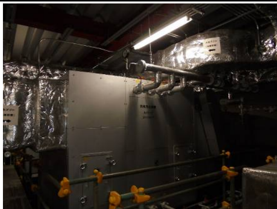
IM-65 熱風発生装置+ダクト
