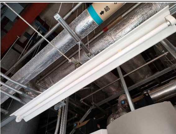
i-11) ボイラー室照明
