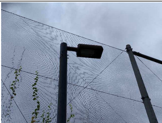
i-5) 灯具(発錆有り)
