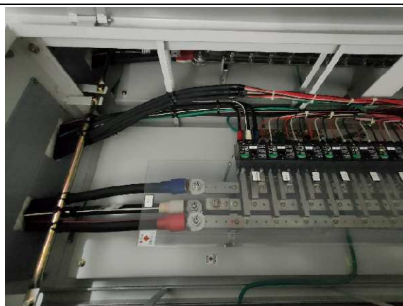
i-28) 分電盤 1MP-1 内部状況
