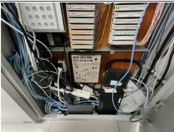
i-71) 端子盤内部状況
