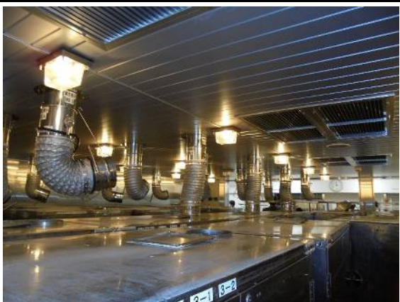
IM-51 排気ダクト(消毒保管庫に接続使用)
