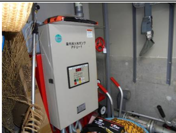
IM-11 屋内消火栓ポンプユニット
