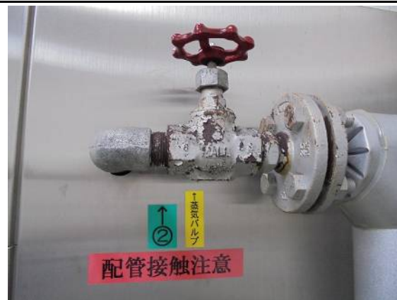
IM-47 蒸気バルブ(サビ発生)
