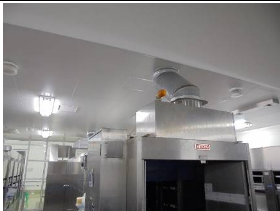
IM-57 洗浄機排気ダクト
