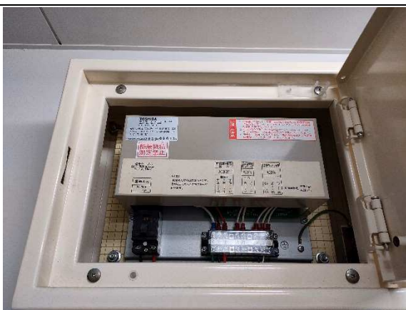
i-57) オートリリフター昇降制御盤内部状況
