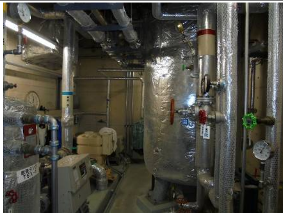
IM-13 ボイラー室内貯湯タンク・配管保温状況
