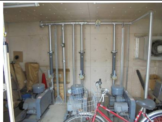
IM-8 排水処理槽用ブロワー
