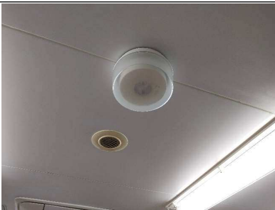
i-33) 非常用照明器具 (HACCP 対応)
