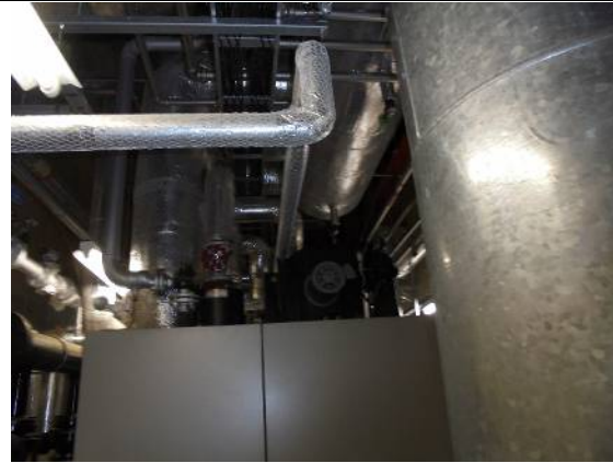
IM-14 ボイラー室内煙導断熱状況
