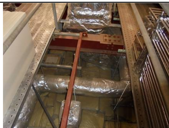
IM-61 天井内床下(1階天井裏)配管ダクト
