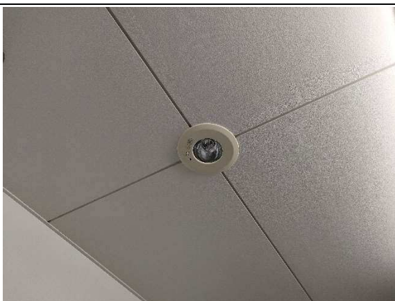
i-61) 非常用照明
