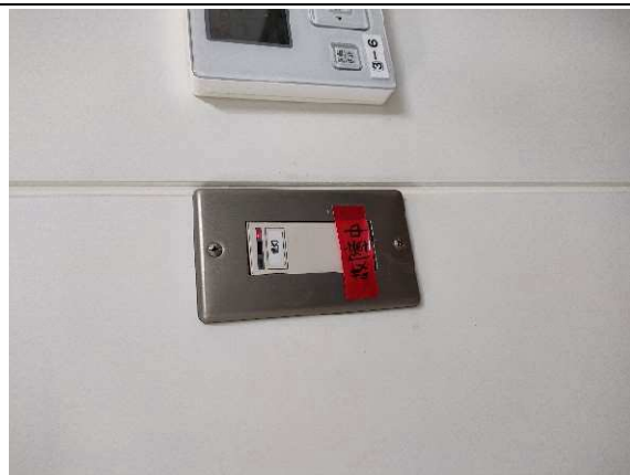
i-40) リモコンスイッチ (破損有り)
