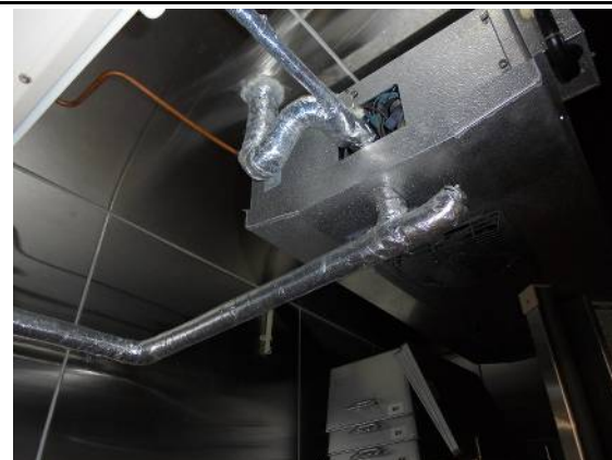
IM-31 エアコン用冷媒・ドレン管
