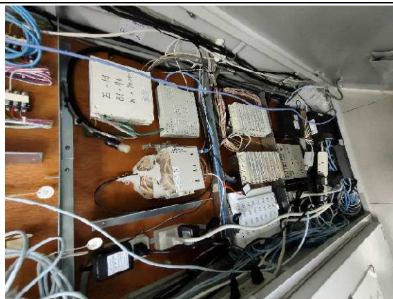
i-70) 端子盤内部状況
