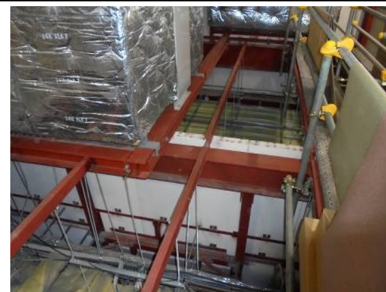
IM-64 天井内床下(1階天井裏)配管ダクト
