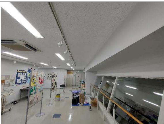
i-79) 2 階廊下照明器具
