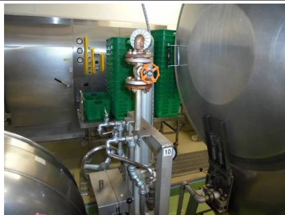
IM-42 回転釜用蒸気配管
