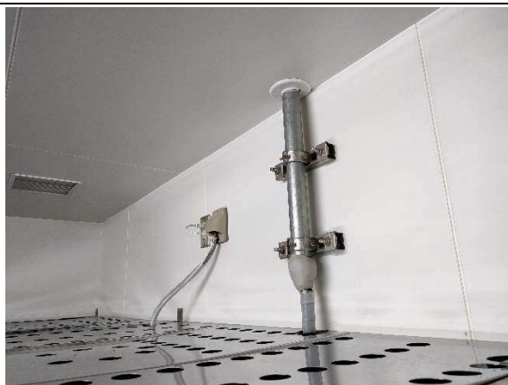
i-36) 配管配線状況
