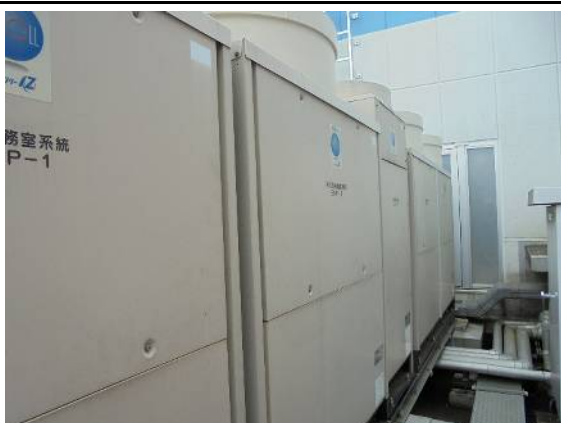
IM-72 マルチエアコン室外機
