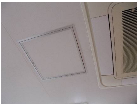
IM-27 エアコン点検口
