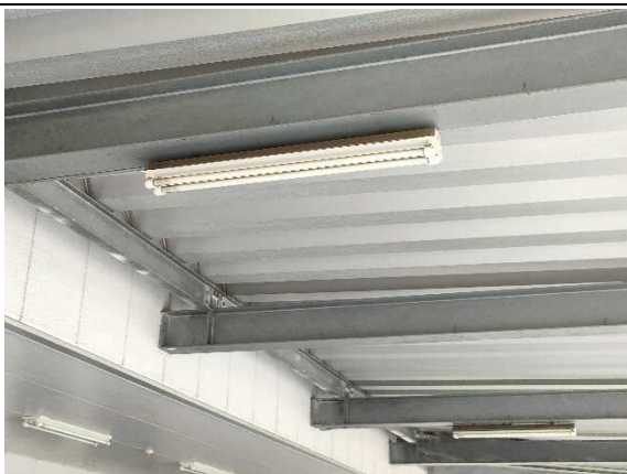
i-7) 灯具(汚損有り)
