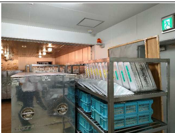
i-63) シャッター設備(電源)
