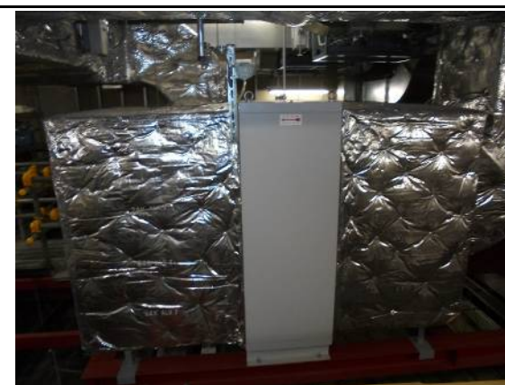
IM-62 天井内空調・換気ダクト
