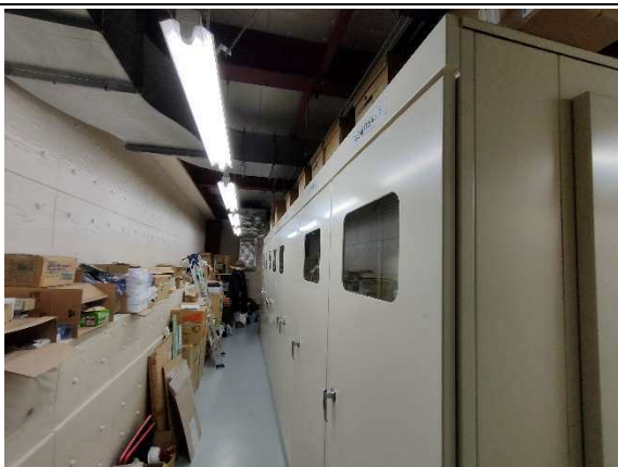
i-83) 受変電設備
