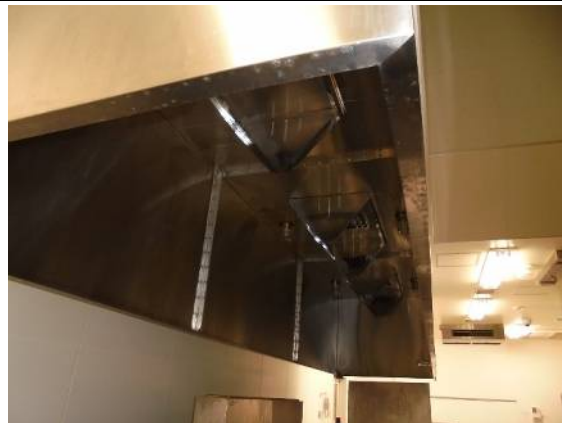
IM-29 排気フード内状況
