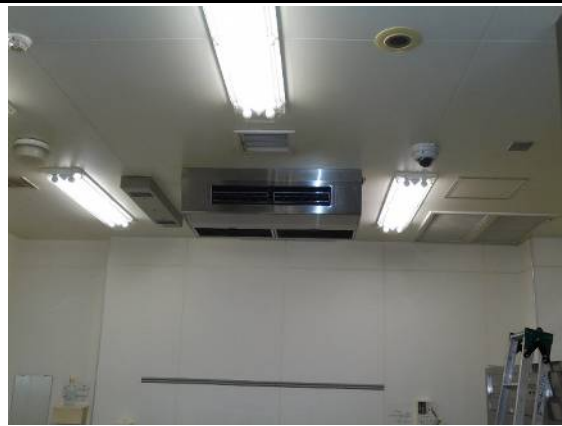
IM-35 天吊り型エアコン
