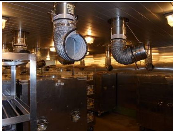
IM-49 排気ダクト(消毒保管庫に接続使用)
