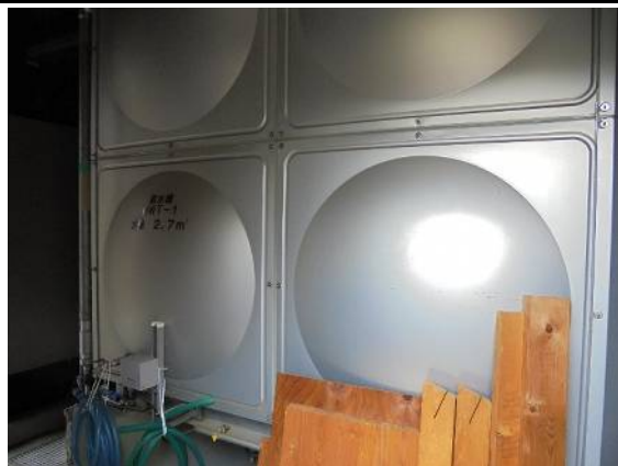
IM-9 蒸気用還水槽
