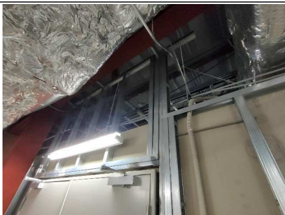
i-80) 天井内配線状況
