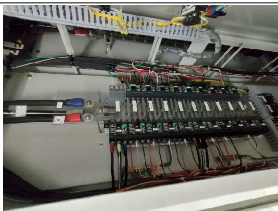
i-27) 分電盤 1MP-1 内部状況
