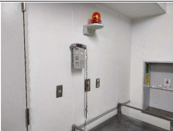
i-53) 一般電話機(断線有り)
