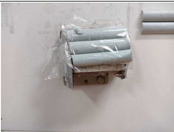
i-37) 防水コンセント破損状況
