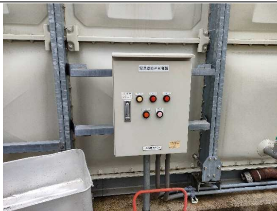
i-10) 受水槽盤類
