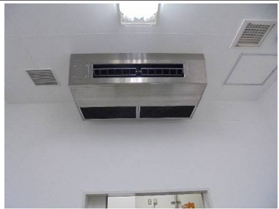
IM-34 天吊り型エアコン
