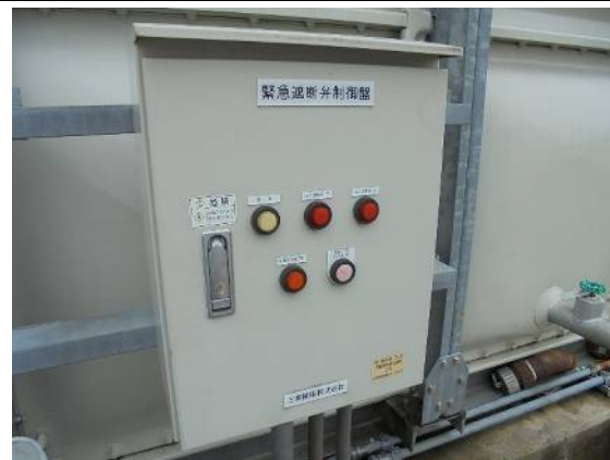
IM-6 給水緊急遮断弁用制御盤
