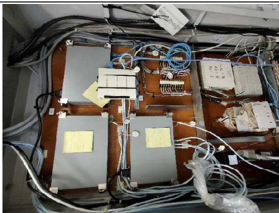
i-69) 端子盤内部状況
