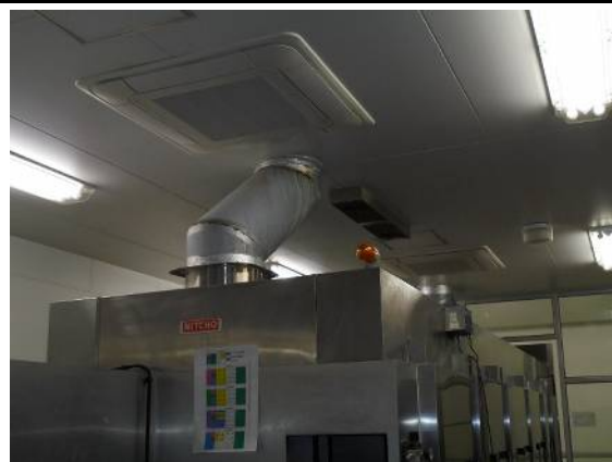
IM-58 洗浄機排気ダクト、天井カセットエアコン
