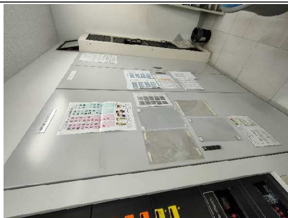
i-68) 分電盤、端子盤 1L-1 1T-1
