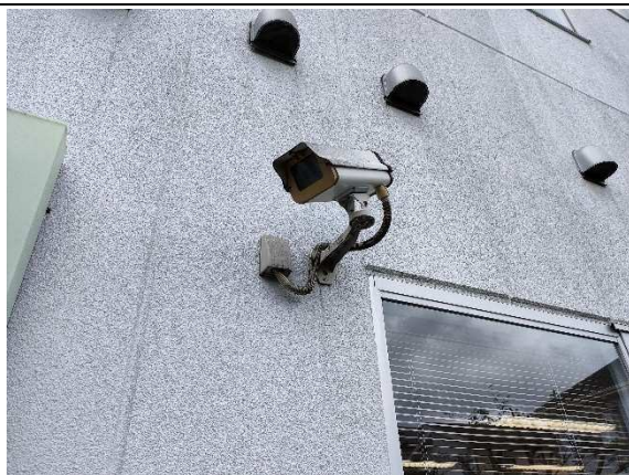
i-16) 監視カメラ(配管破損有り)
