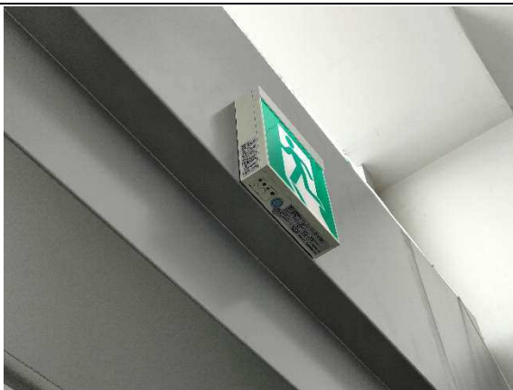
i-25) 避難口誘導灯
