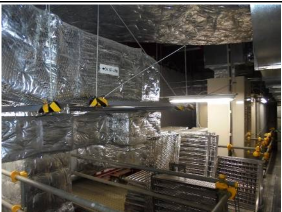
IM-59 天井内空調・換気ダクト
