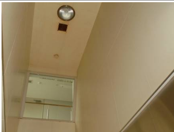
IM-37 吹抜部分排気用吸込口
