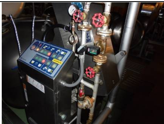
IM-53 蒸気配管
