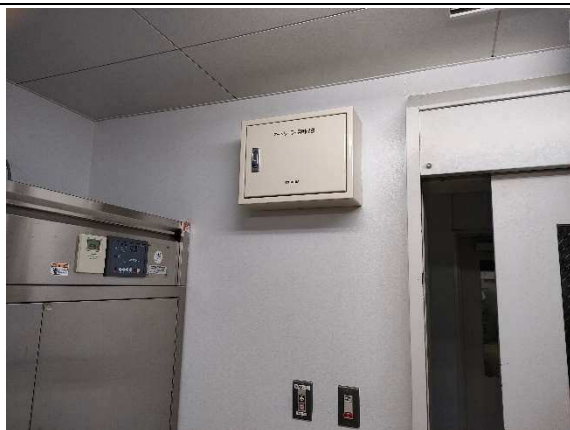
i-56) オートリフター昇降制御盤
