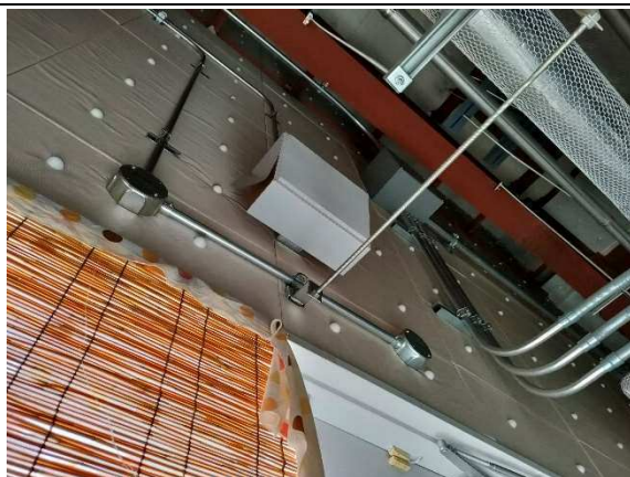
i-12) ボイラー室スピーカー破損有り
