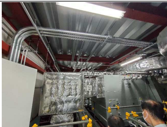
i-82) 機械室内配管状況
