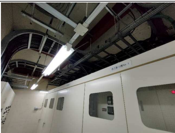
i-19) 電気室ラック配線状況
