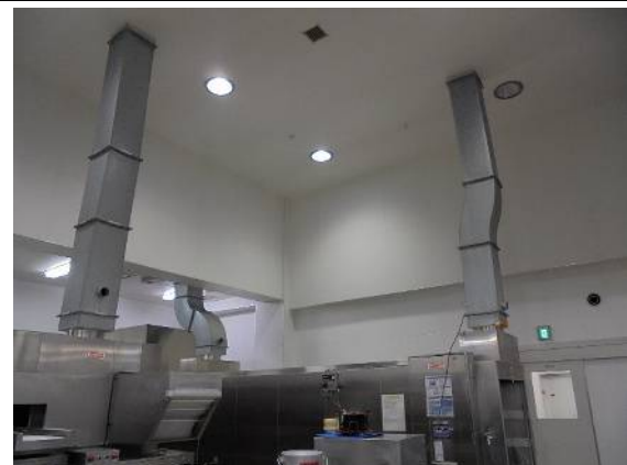
KM-38 洗浄機排気ダクト
