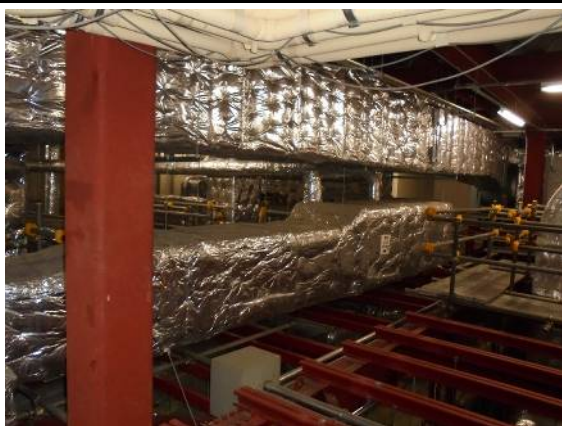
KM-51 天井内空調・換気ダクト
