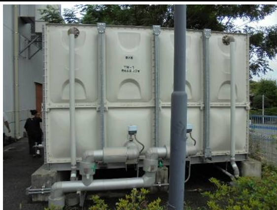
KM-3 受水槽、給水緊急遮断弁
