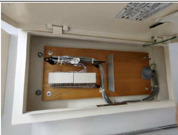
i-51) 端子盤内部状況
