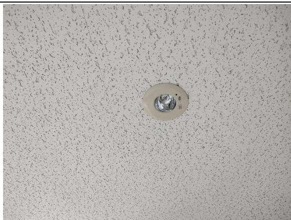
i-32) 非常用照明
