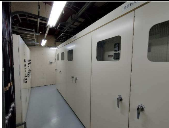
i-18) 受変電設備
