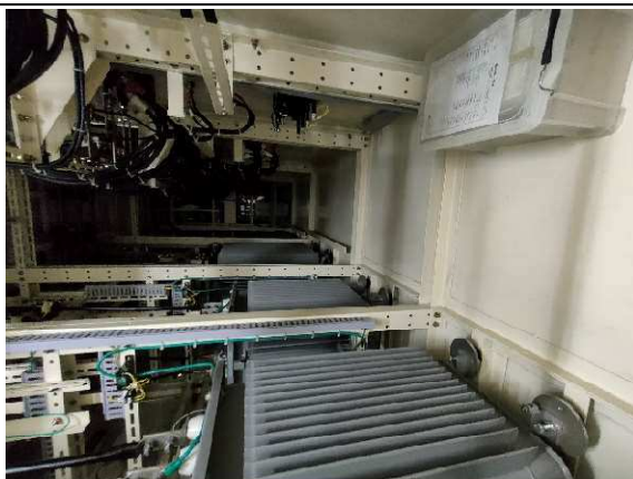
i-23) キュービクル内部状況
