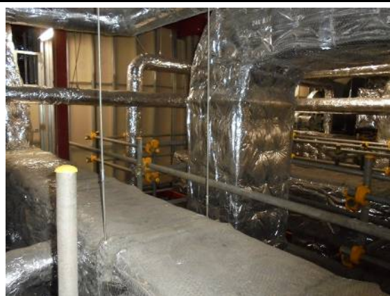
KM-52 天井内空調・換気ダクト、衛生設備配管
