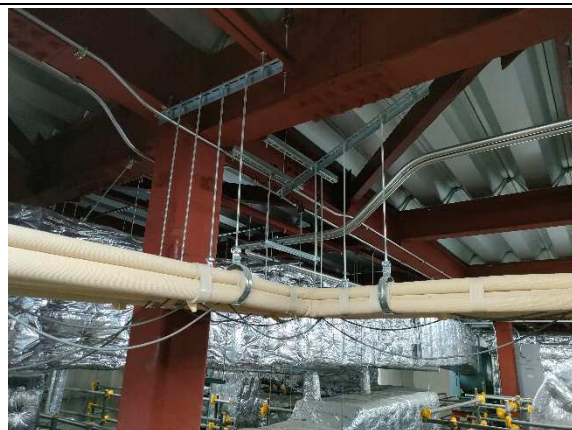
i-16) 機械室内配管状況
