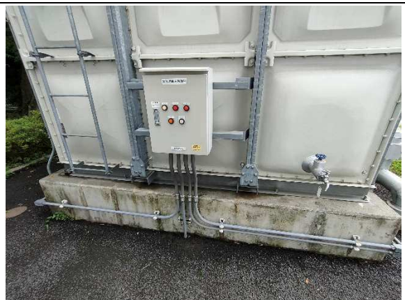
i-8) 受水槽盤類
