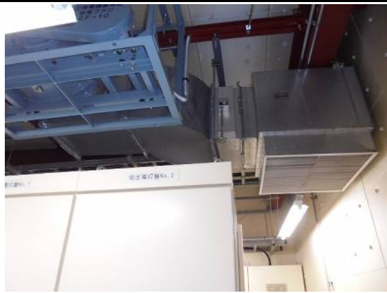
KM-58 電気室排気ファン
