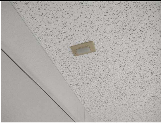
i-33) 廊下表示灯(トイレ呼出)
