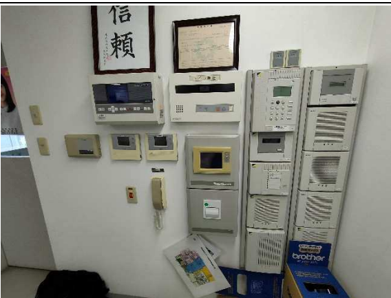
i-61) 事業者事務室取付機器
