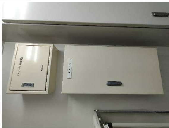
i-50) オートリフター昇降制御盤, 1T-2
