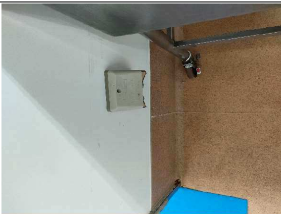
i-49) 防水コンセント(破損有り)
