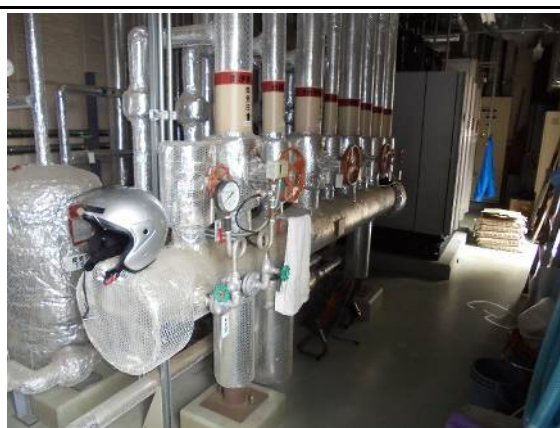
KM-14 蒸気ヘッダー
