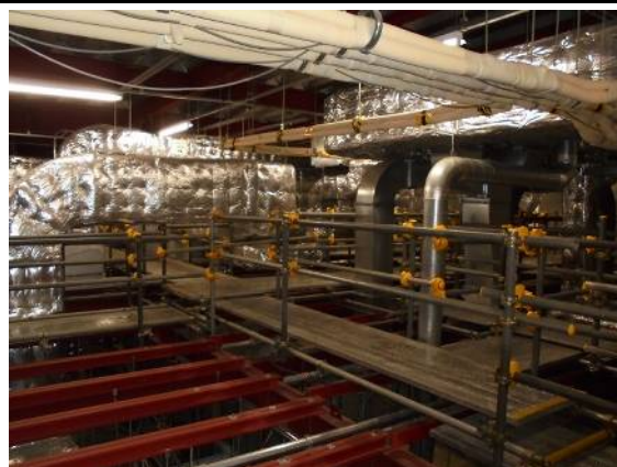
KM-50 天井内空調・換気ダクト、冷媒管
