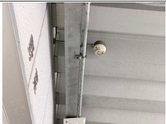
i-38) 感知器(汚損有り)
