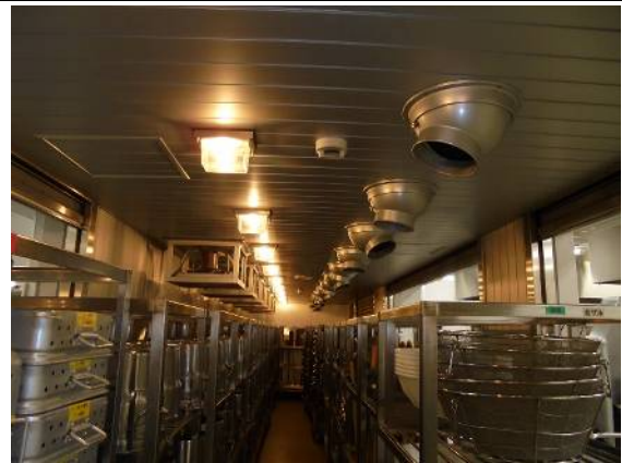
KM-34 空調吹出口、循環ファン
