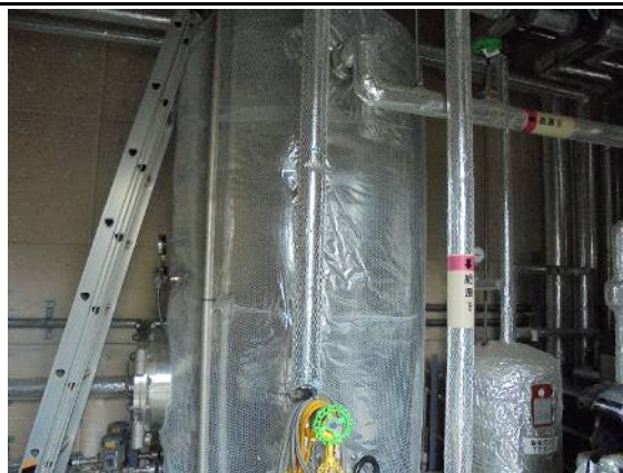
KM-12 ボイラ室内貯湯タンク・配管保温状況
