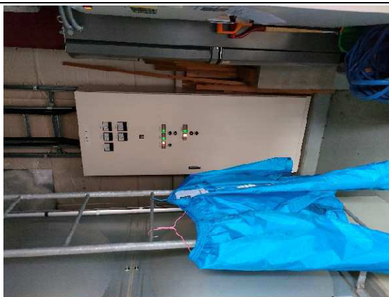
i-5) ボイラー室盤類
