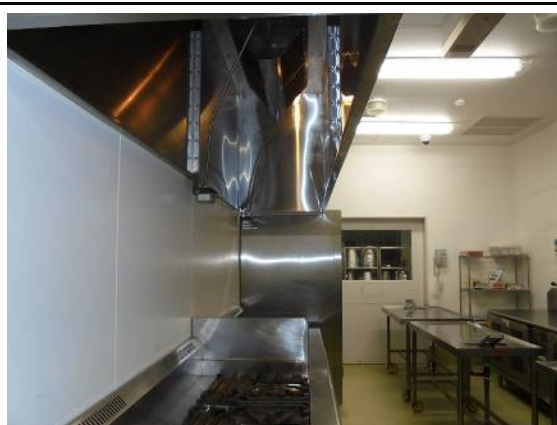
KM-28 排気フード内状況
