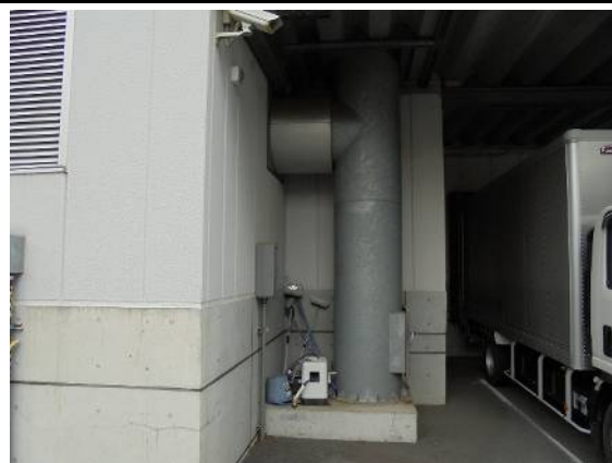
KM-2 ボイラ煙突
