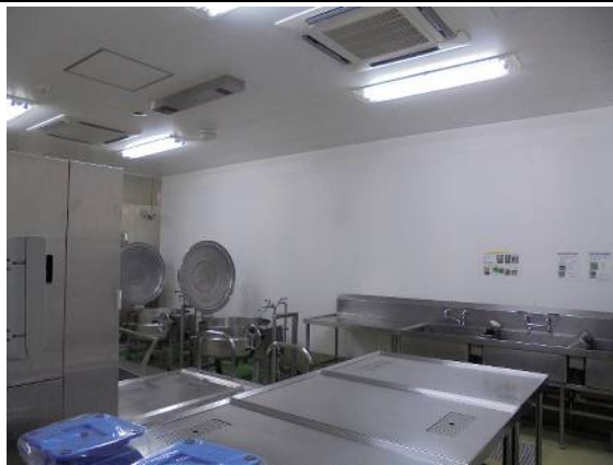
KM-24 天井カセットエアコン
