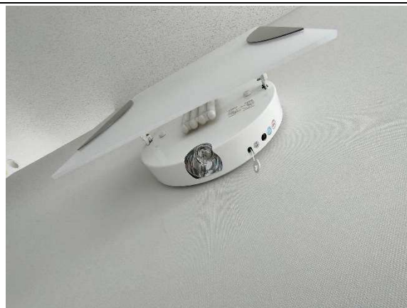
i-14) 非常用照明
