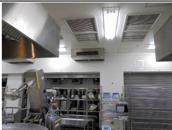
KM-27 天吊り型エアコン、外気取入用吹出口
