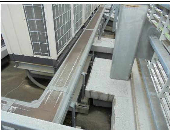
KM-62 マルチエアコン室外機、冷媒管化粧カバー
