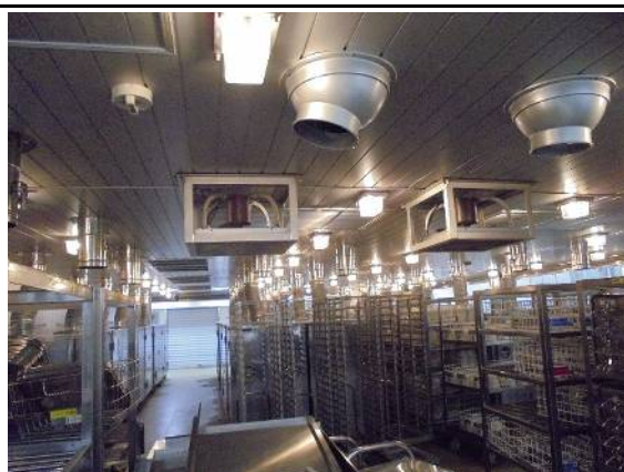
KM-32 空調吹出口
