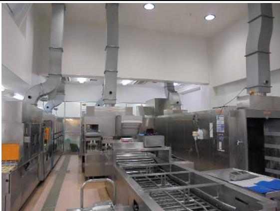
KM-39 洗浄機排気ダクト
