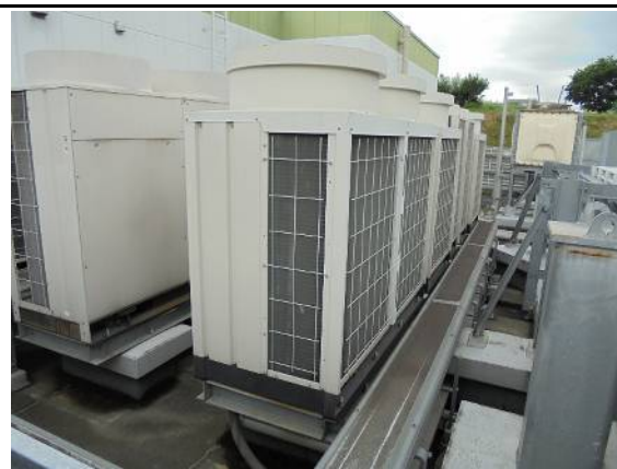
KM-61 マルチエアコン室外機
