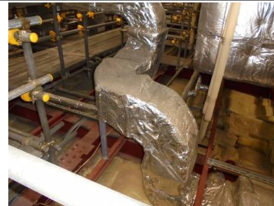
KM-54 天井内空調・換気ダクト
