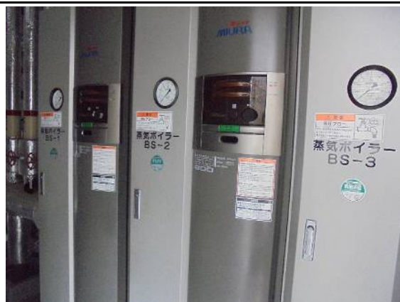
KM-11 蒸気ボイラ
