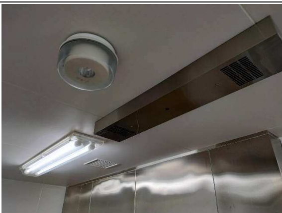
i-39) 非常用照明(HACCP 対応)
