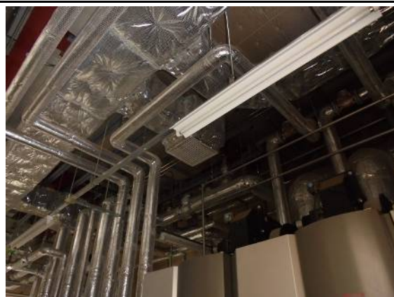
KM-15 ボイラ室外気取入ダクト
