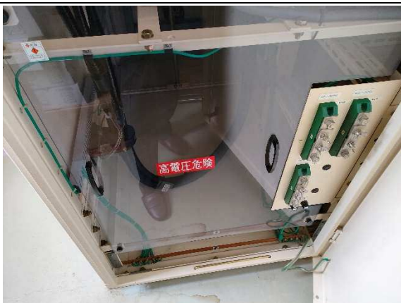
i-27) 高压ケーブル
