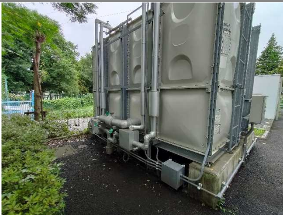
i-9) 受水槽電線管他
