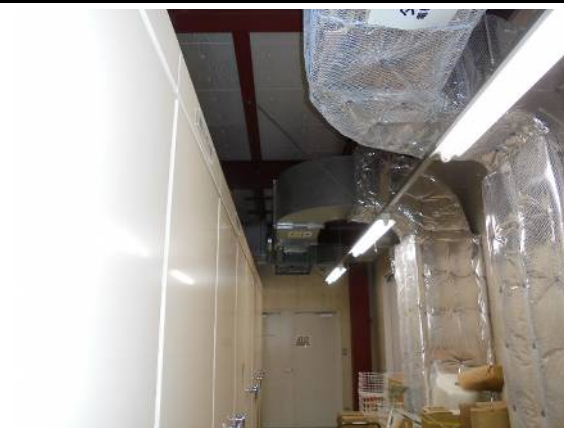
KM-59 電気室給気・排気ダクト
