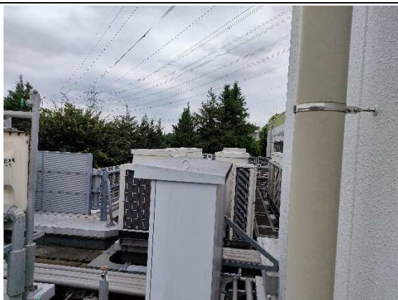
i-56) 動力盤 2P-1(上部)
