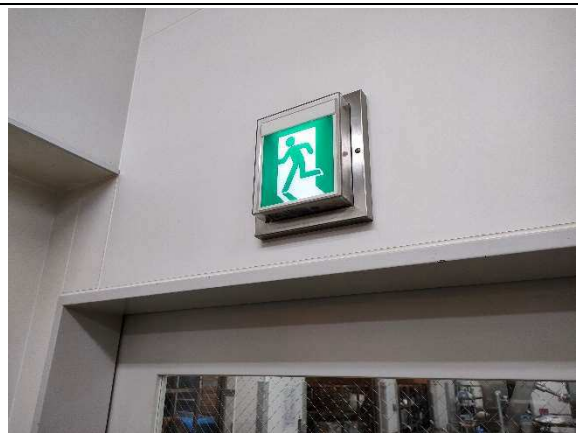
i-46) 避難口誘導灯 (HACCP 対応)
