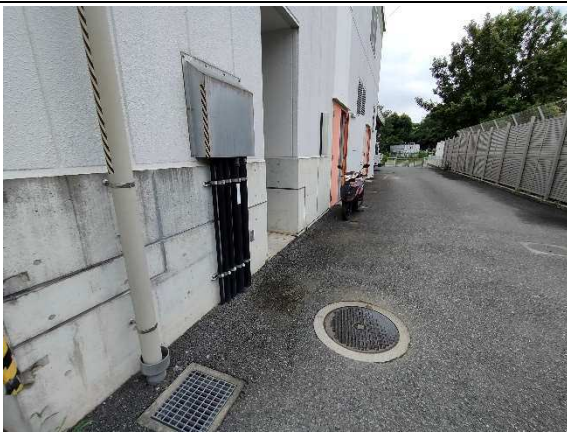
i-3) ハンドホール、管路
