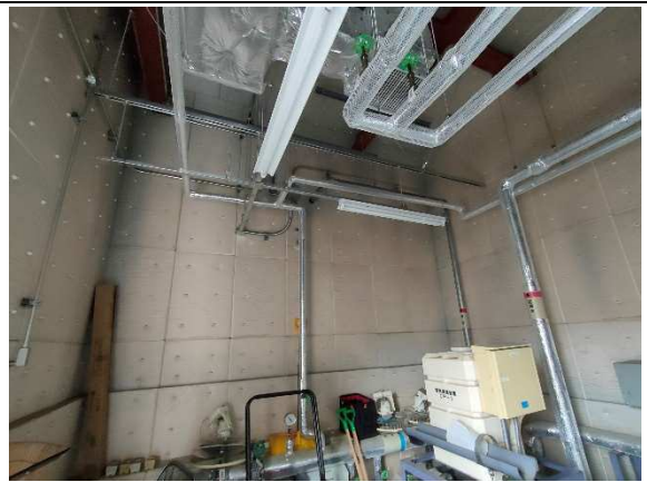
i-4) ボイラー室照明他
