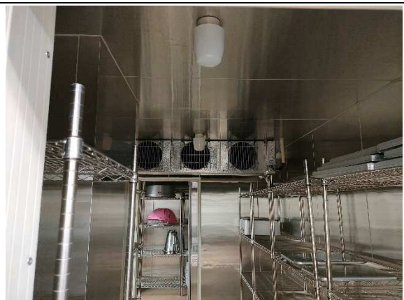
i-40) 冷凍庫内照明
