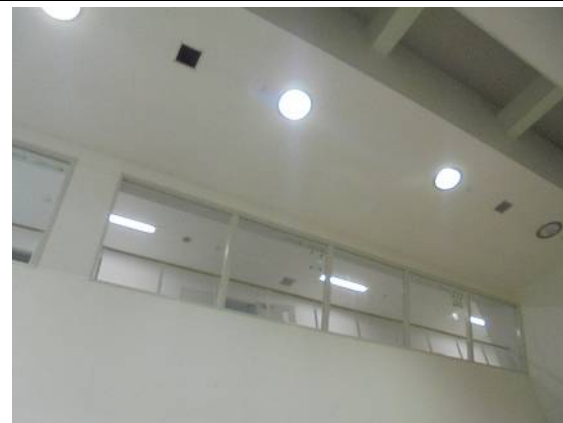
KM-45 吹抜部分排気用吸込口
