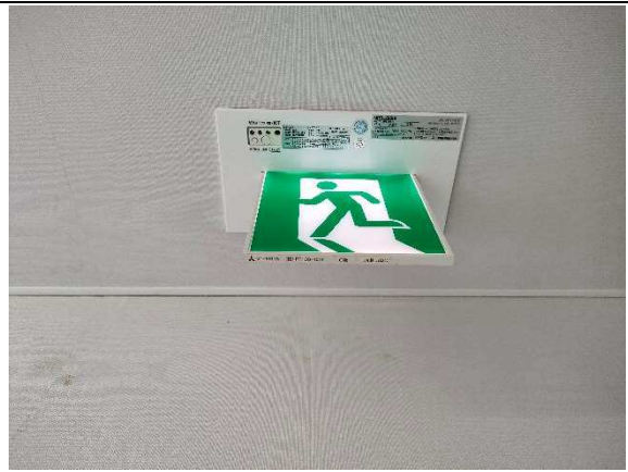
i-34) 避難口誘導灯
