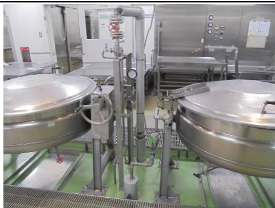
KM-26 回転釜用蒸気配管
