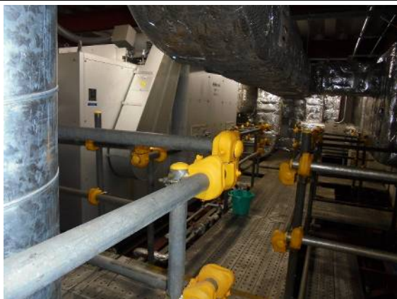
KM-53 天井内給気・排気用フィルターユニット
