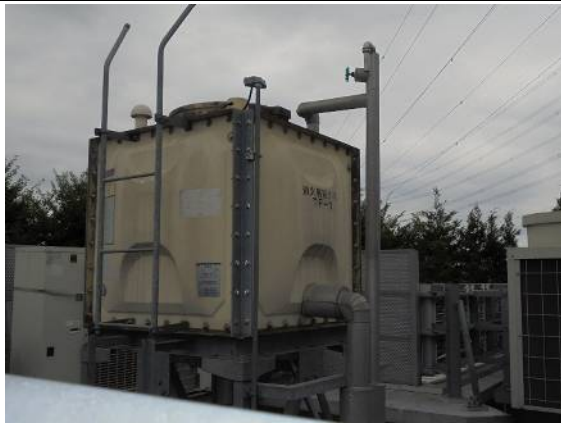
KM-65 消火用補助水槽
