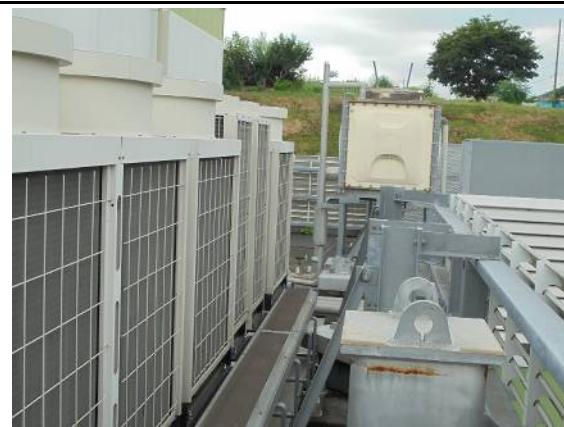
KM-63 マルチエアコン室外機、消火用補助水槽
