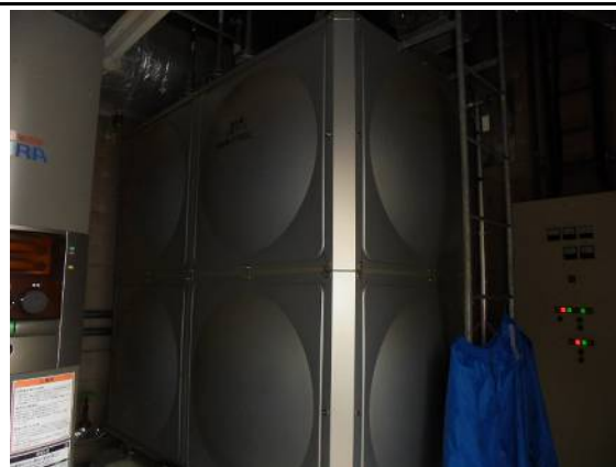
KM-10 蒸気用還水槽
