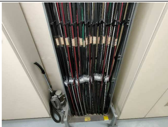
i-20) 電気室ラック配線状況
