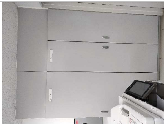
i-64) 分電盤、端子盤 1L-1 1T-1
