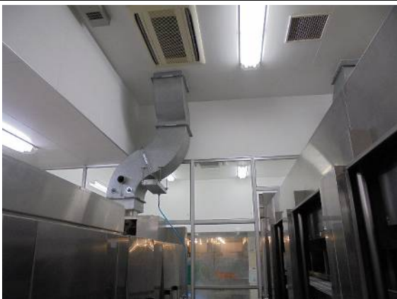
KM-37 洗浄機排気ダクト、天井カセットエアコン
