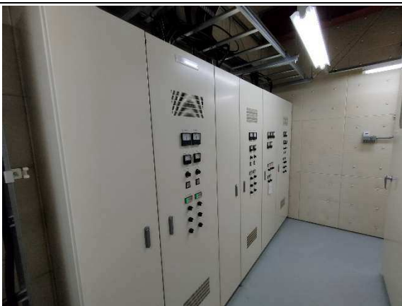
i-21) 受変電設備
