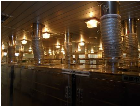
KM-33 排気ダクト(消毒保管庫に接続使用)
