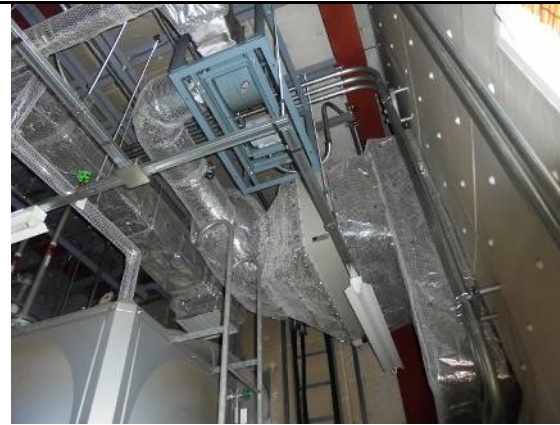
KM-16 ボイラ給気ファン
