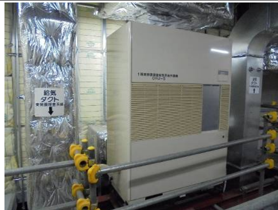
KM-46 外気処理空調機
