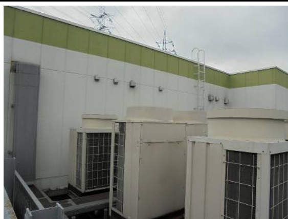
KM-60 マルチエアコン室外機
