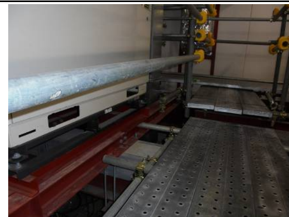
KM-47 外気処理空調機据付状況
