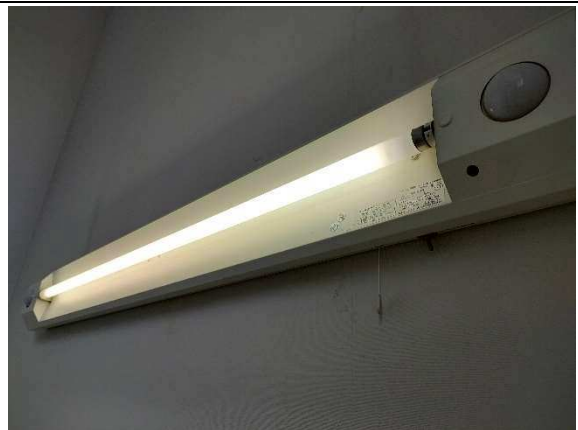
i-36) 階段通路誘導灯
