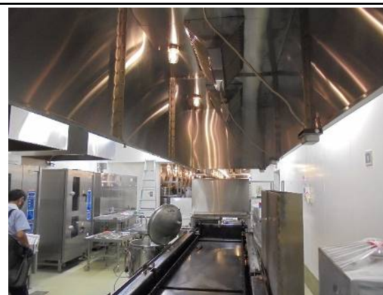
KM-30 排気フード内状況
