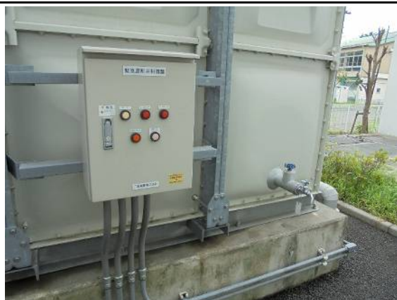
KM-5 給水緊急遮断弁
