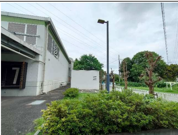
i-7) ポール灯 (灯具発錆有り)
