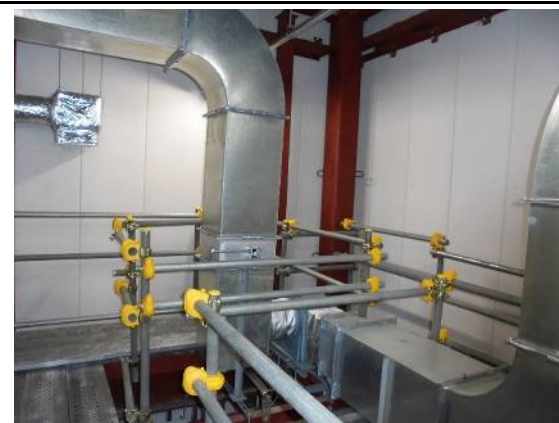
KM-48 天井内排気ダクト
