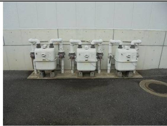
KM-6 都市ガスメーター
