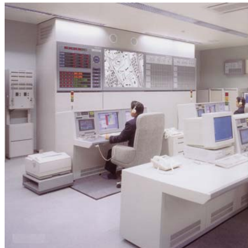
通信指令施設
