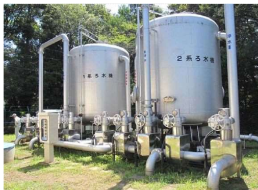
柏原浄水場除鉄除マンガン設備
