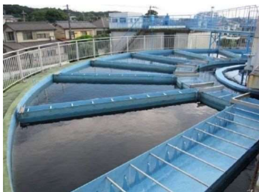
鶺ノ木浄水場高速凝集沈殿池
