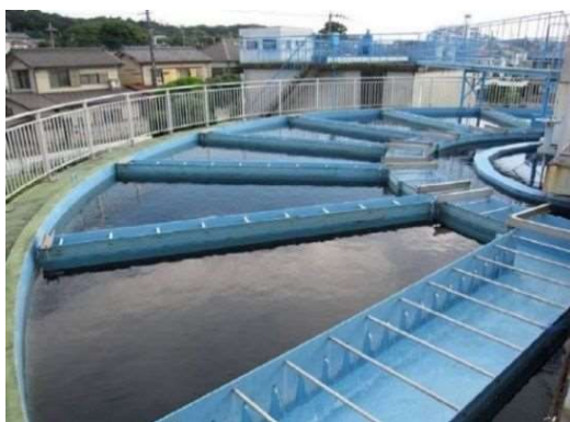
鶉ノ木浄水場高速凝集沈殿池
