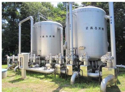
柏原浄水場除鉄除マンガン設備
