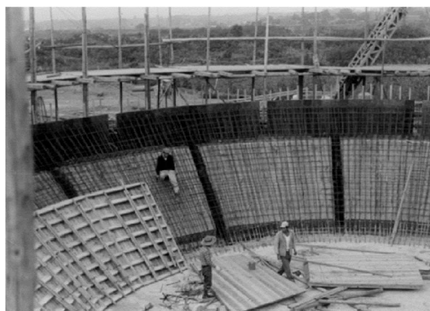
高速凝集沈澱池
