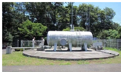
水野浄水場 貯水槽
