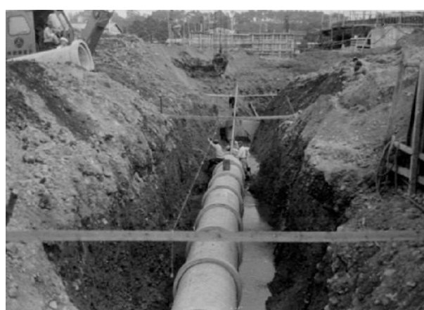
入間川からの導水管
