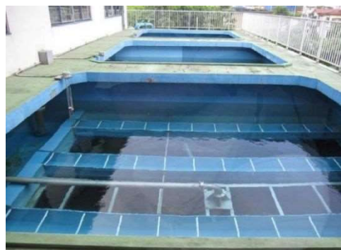
鶺ノ木浄水場急速ろ過池
