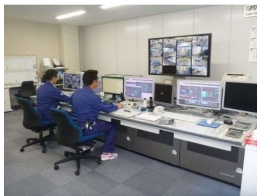
鶉ノ木浄水場中央監視室
