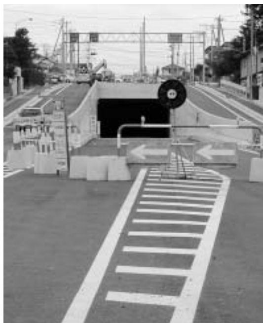
工事中の東京狭山線(10月完成予定)を、奥富方面から国道16号に向けて眺めたところ
