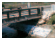
護岸が崩れた釈迦堂橋
