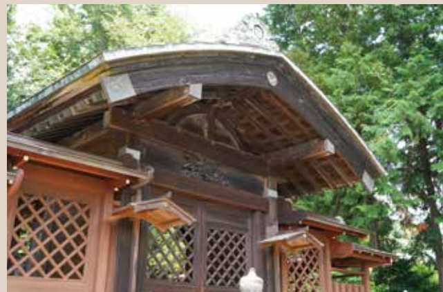
▲笹井白髭神社の本殿前の奏上門。一部が焼夷弾で焼け焦げて炭化している
