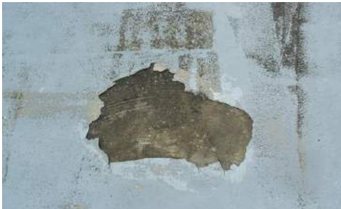
写真1 柏原中学校 露出防水 全体的に塗装が剥離しており、破れている。
