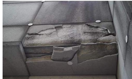
写真2 稲荷山環境センター(工場棟) セメント系のスラグタイルが剥落している。
