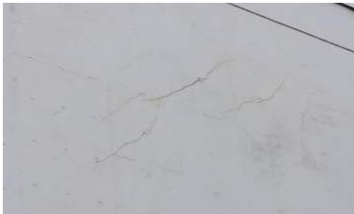
写真1 入間川小学校 ひび割れが見られる。
