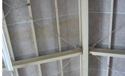
写真1 狭山台中学校 金属屋根 台風等の豪雨時に棟部分から漏水している。
