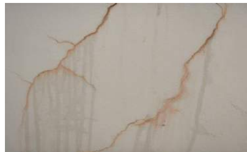
写真2 市民健康文化センター 錆汁を伴ったひび割れが見られる。
